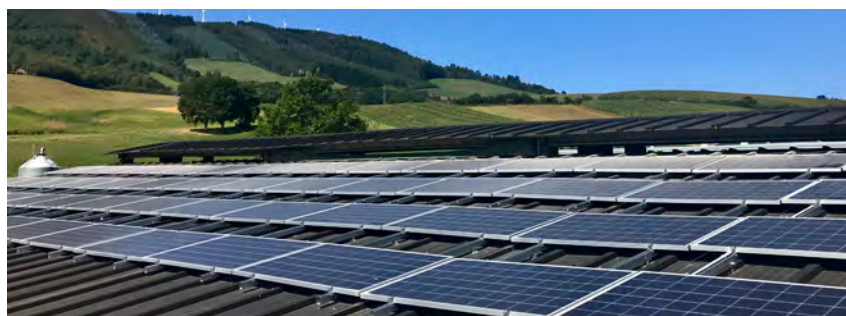
Tienen instaladas placas solares con las que ahorran en torno a un 20 % de la factura eléctrica anual. Para contribuir al ahorro energético también cuentan con variador, intercambiador de placas -que aprovechan para templar el agua de los bebederos en épocas frías- y recuperador de calor
