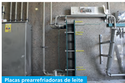
Placas prearrefriadoras de leite
