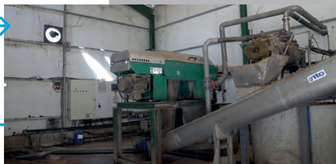
Planta de clarificación e deshidratación de xurro
