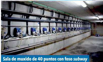
Sala de muxido de 40 puntos con foso subway
