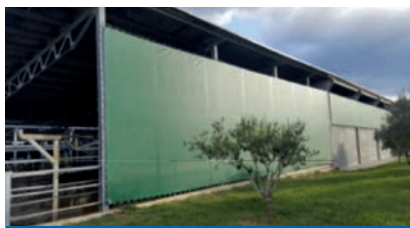
8. Cortinas de plástico para dar sombra e evitar a penetración da radiación solar no patio de espera dunha granxa leiteira a grande escala no sur de Italia
