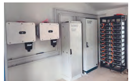
Cuadro de instalaciones tipo. De izquierda a derecha, se pueden observar inversores fotovoltaicos, convertidor electrónico de potencia para baterías, cuadro general y rack de baterías
