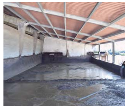
Las fosas, con una capacidad total de un millón y medio de litros, son cubiertas
